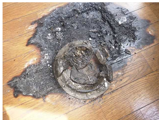
溜まっていた吸いからが原因で火災化した事例
