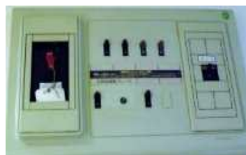
玄関付近にあるブレーカー
